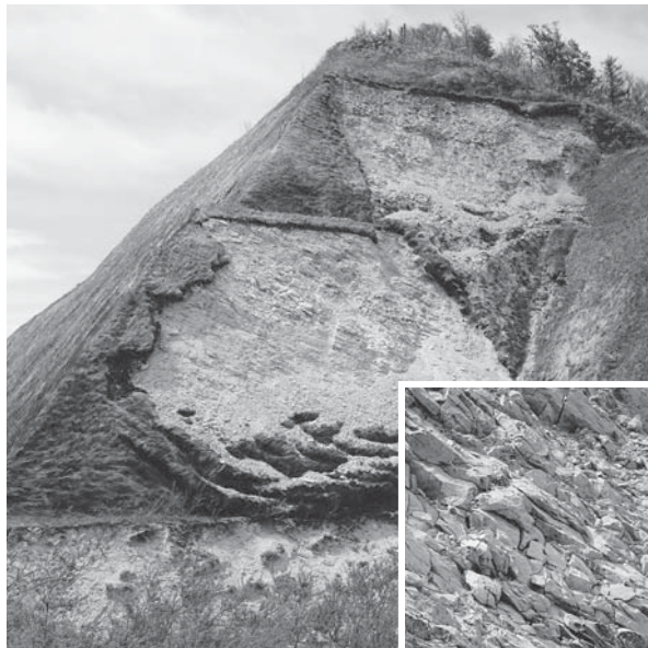
一部の斜面が崩落し、泥岩が露出した箕ノ輪山採石跡地
