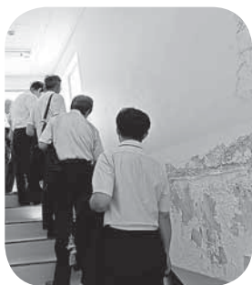
階段の壁などで雨漏り
