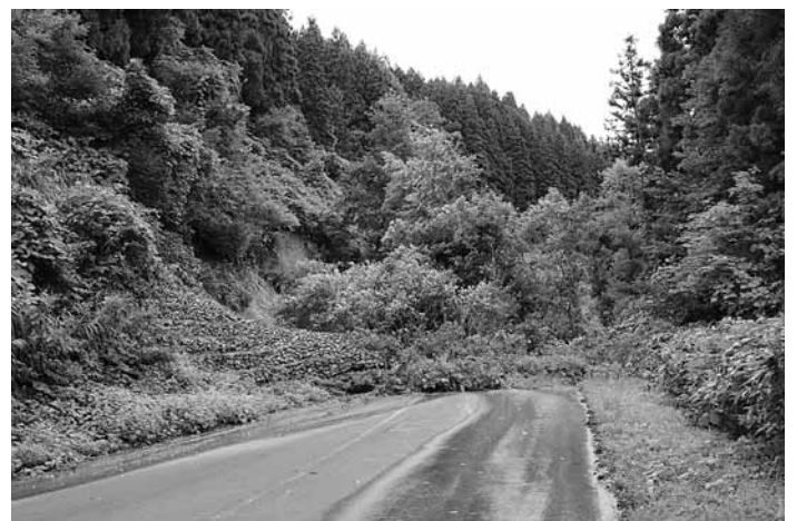
最終処分場候補地まで続く道路の一部が土砂崩れで通行止めに
