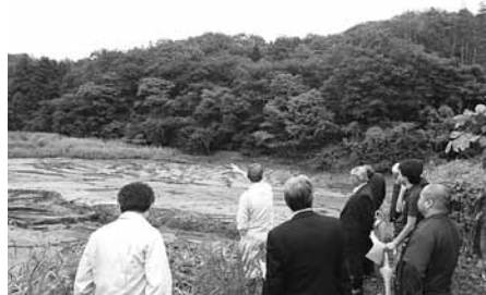
決壊した大池沢ため池（宮崎地区桜町）
