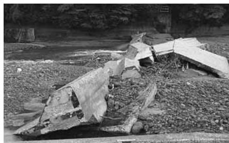
基礎ごと破壊され流された入合堰（小野田地区）
